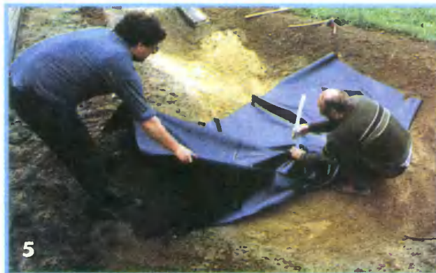
5 Трубу для перекачки воды протаскивают через пленку. Чтобы в этом месте не образовалась течь, края отверстия уплотняем специальным клеем (так называемой жидкой пленкой)
