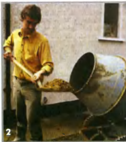
2 Гравий и смесь цемента с песком загружают в бетономешалку лопатой, постепенно добавляя воду
