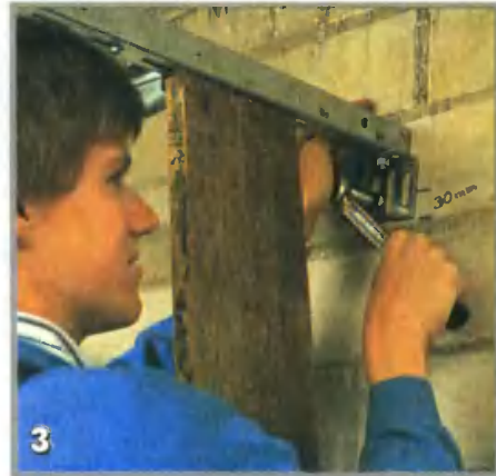
Направляющие шины выставляют на 30 мм ниже отметки перекладины ворот. Теперь можно прикрепить уголки к стене
