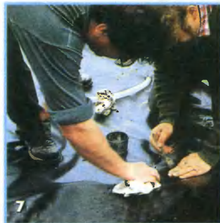
7 Одно из важнейших вспомогательных средств при устройстве ручья — жидкая пленка, надежно уплотняющая стыки
